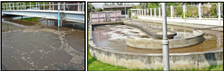
รูปที่ 9 บ่อเติมอากาศชนิดต่างๆ
