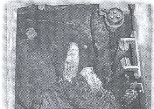
ภาพของส่วนสูบน้ำทิ้งที่ผิดปกติมีขยะและตะกอนลอยติด
