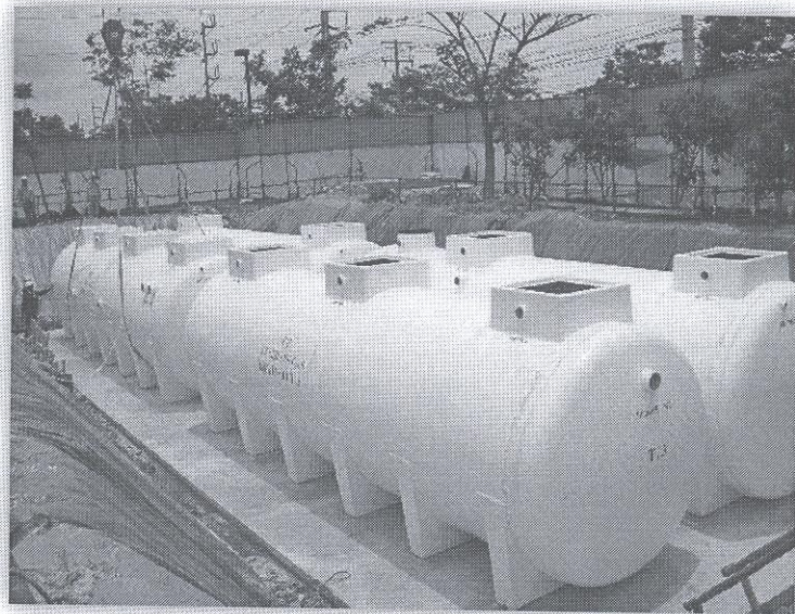
ภาพถ่ายที่ ๕ : อีกแบบของถังบำบัดน้ำเสียแบบฝังดินที่ใช้งานกับคนงานในโรงงานอุตสาหกรรม
